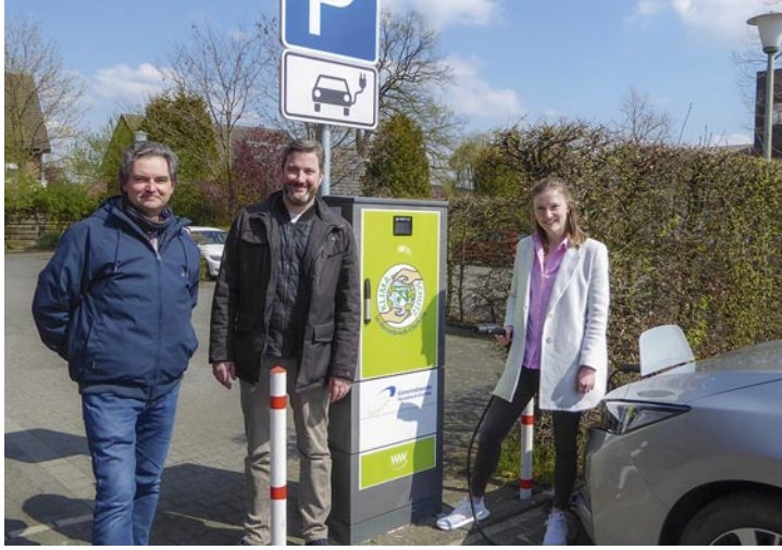
Der stellvertretende Betriebsleiter der Gemeindewerke Marco Schröder, Bürgermeister Marco Diethelm und die Klimaschutzmanagerin Carolin Hüttemann sind froh, dass neun von zehn neuen E-Ladesäulen jetzt betriebsbereit sind.
